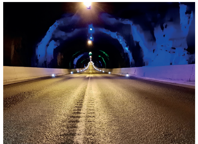
Illuminazione di tunneli Nordoyatunnel Färöer
